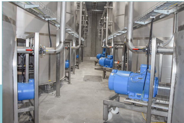
El nuevo depósito instalado
